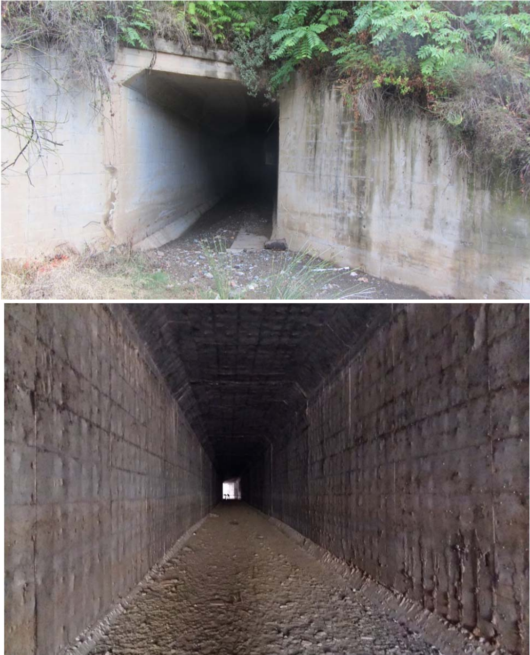
Figura 6.1 Detall d'un dels accessos de l'estructura CR42-P1 sota la carretera C-58, i del seu interior. S'observa la reduïda visió de la boca oposada i la gran longitud de l'estructura (150 m). A més, un tub de drenatge desemboca a l'interior de l'estructura, fet que pot comportar la seva inundació en períodes de pluges.
