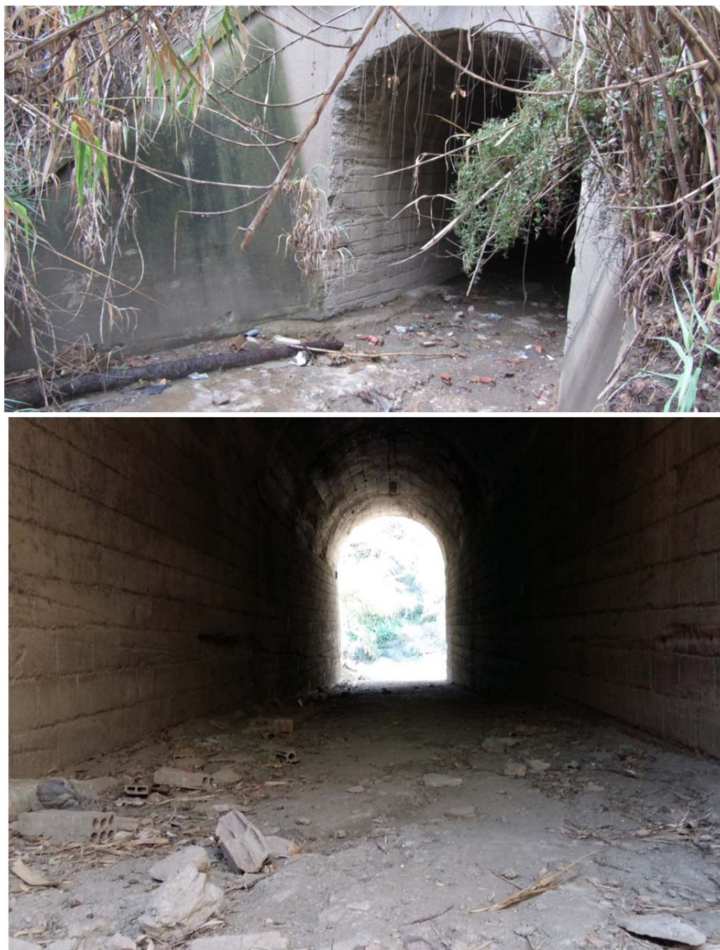
Figura 6.3 Detall d'un dels accessos del pas inferior CR42-P2 sota la carretera N-150, i del seu interior. És possible apreciar les restes de runa presents tant al llarg de l'estructura com en els accessos d'aquesta.
